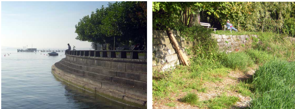
Abbildung 8: Ufermauern beeinträchtigen die Wasser-Land-Durchgängigkeit – mal mehr, mal weniger (Hagnau, 08.10.2007, beide Fotos W. Ostendorp).
