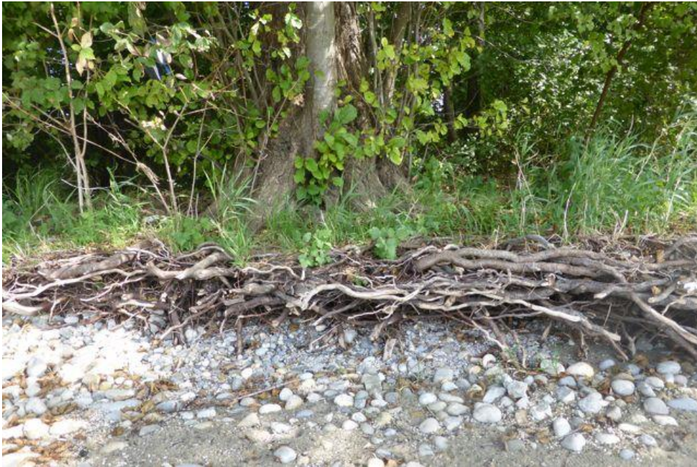
Abb. 6: Unterspülte und mit Kies nachverfüllte Wurzelstöcke
